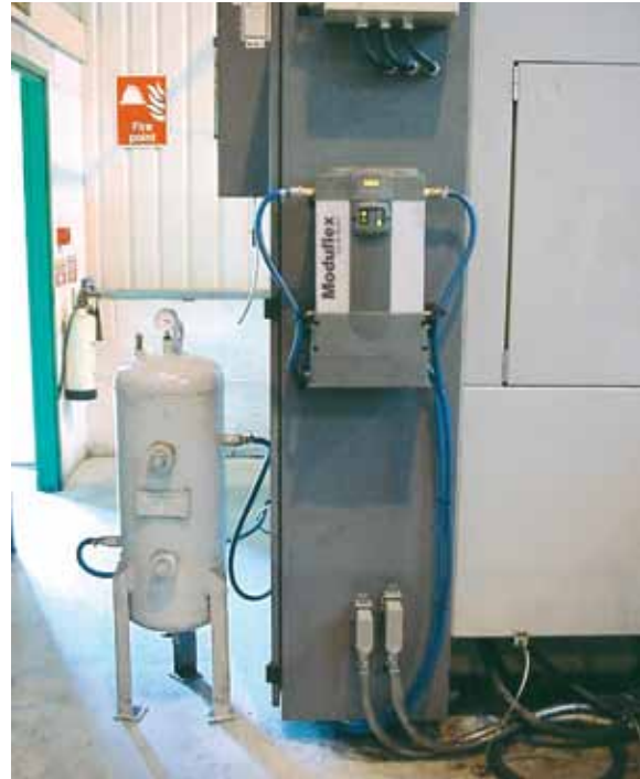
Moduflex Drucklufttrockner für die Steuerluft einer CNC-Drehmaschine
